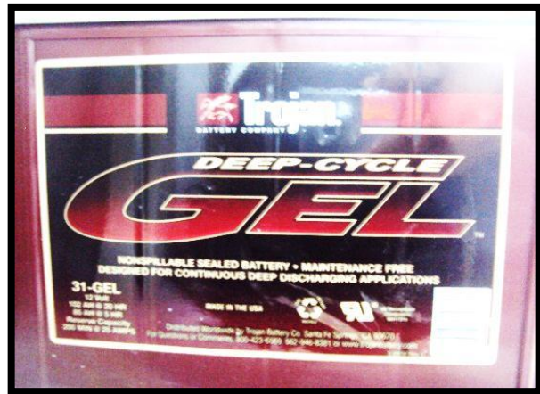
Banco de Baterías
