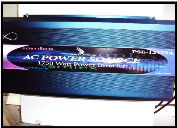
Inversor sin conexión a RED
