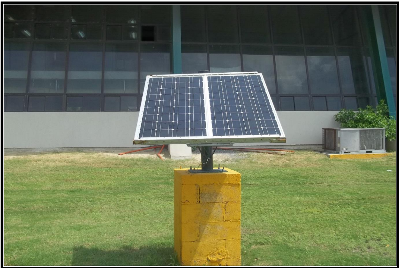
Grafica 3.4. Paneles Fotovoltaicos Instalados en Universidad Tecnológica de Nuevo Laredo
