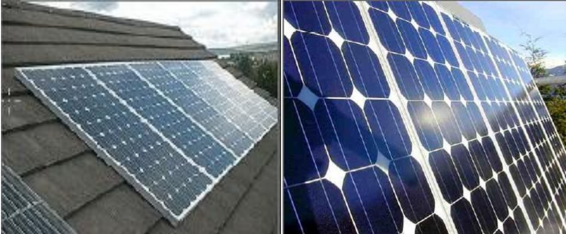
Figura 36.- Hileras de paneles FV.
