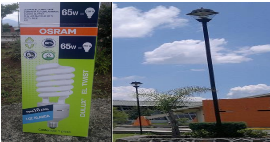
Figura 33.- Lámpara y luminaria utilizada en la UTM, en espacios comunes.
