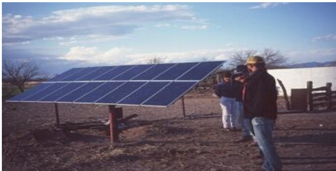
Figura 15. Sistema de bombeo de agua asistido por módulos solares, en El Jeromín, Chihuahua.
