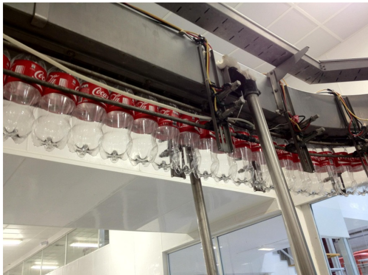
Figura 26. Desperdicio de aire comprimido en transportador línea 4.
