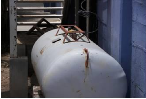
Figura 16. Tanque estacionario de gas atrás del almacén de RP.
