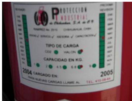
Figura 26. Etiqueta d extinguidor en el almacén de RP.
