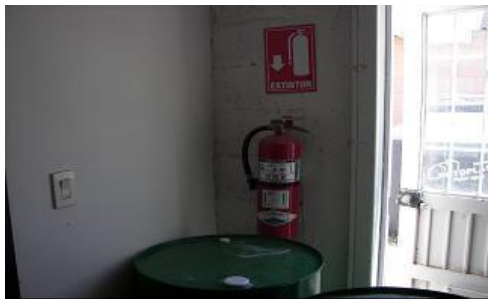
Figura 25. Área de extinguidor.
