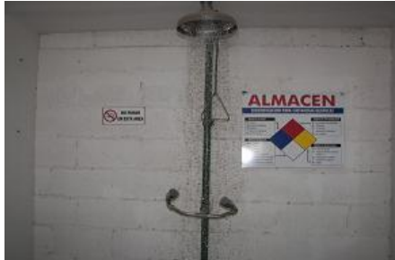
Figura 27. Regadera del almacén temporal de RP.
