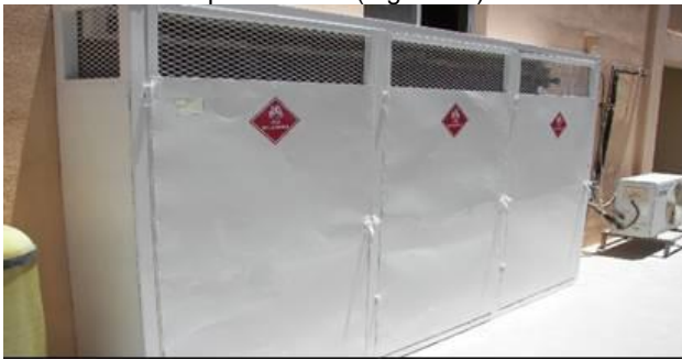
Figura 15. Depósito de gas inflamable.
