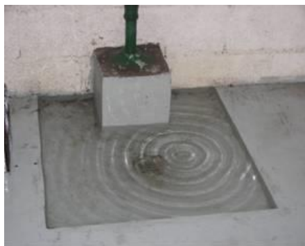
Figura 28. Desagüe de regadera tapado.
