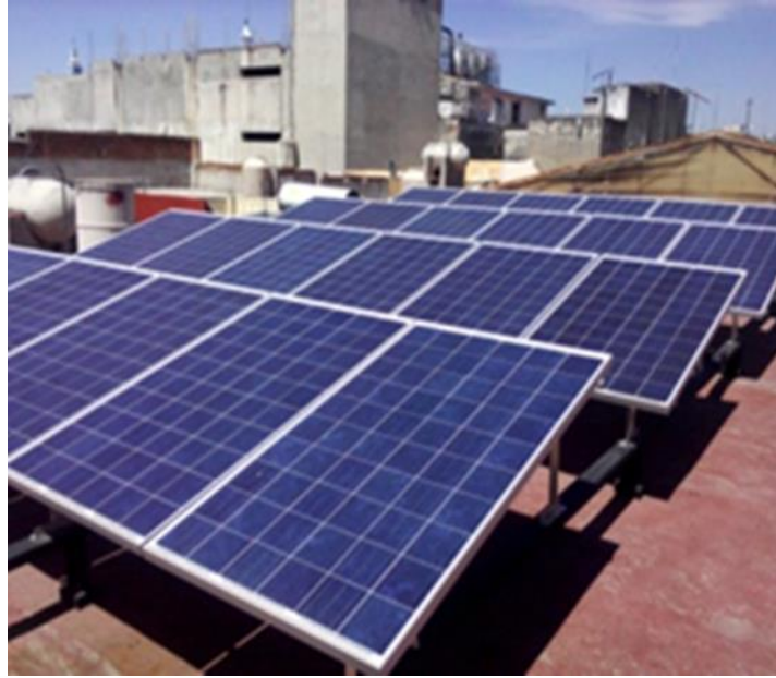
Figura. 14 paneles solares ya instalados
