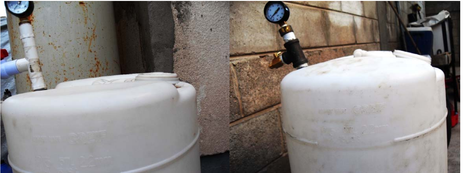
Comparación entre biodigestores mostrando la deformación de la tapa por la presión que ejerce la presencia de gas a las 24 hr. de haber iniciado la fermentación.
