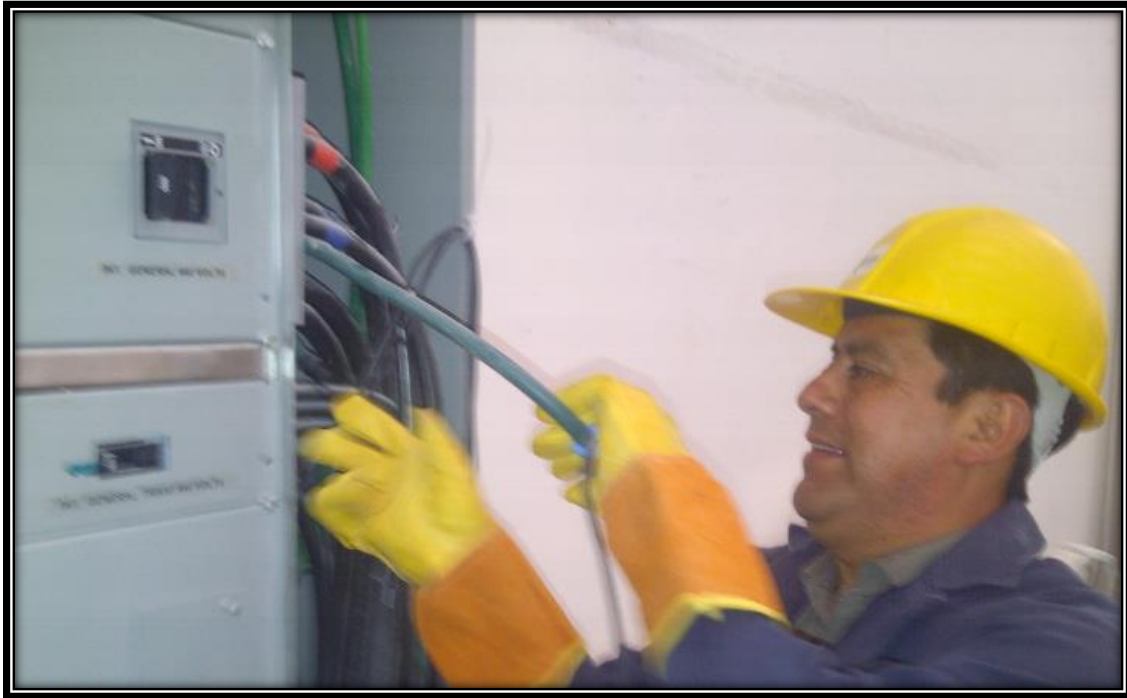
Ilustración 3: Medición en líneas eléctricas
