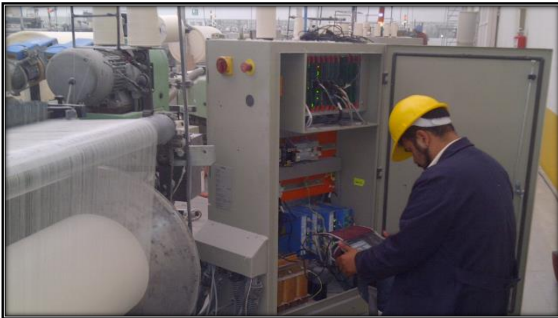
Ilustración 4: Medición con el analizador de redes en tablero para motores
