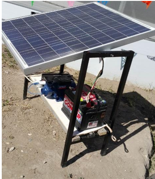
Figura 36. Disposición de los componentes del SGEF, que emplea un panel fotovoltaico de 80W.
