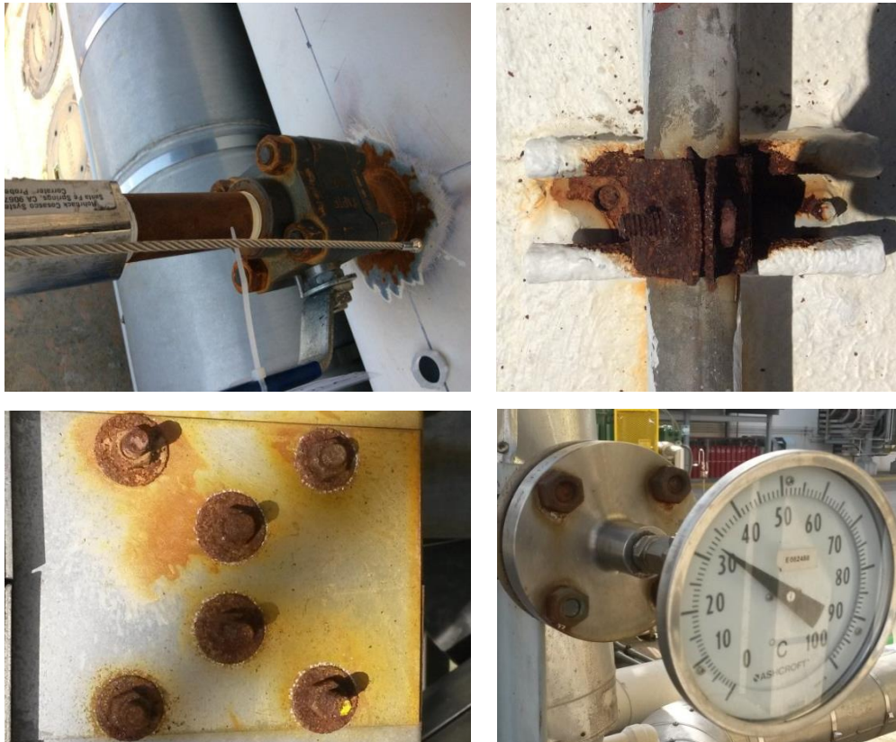
Figura 3. Ejemplos de la estructura metálica corroída de la planta termoeléctrica.
