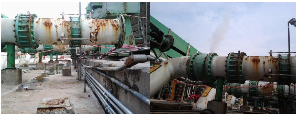
Figura 4. Vista de los efectos corrosivos medio ambientales de la planta de refinación de gases aledaña a la planta termoeléctrica.
