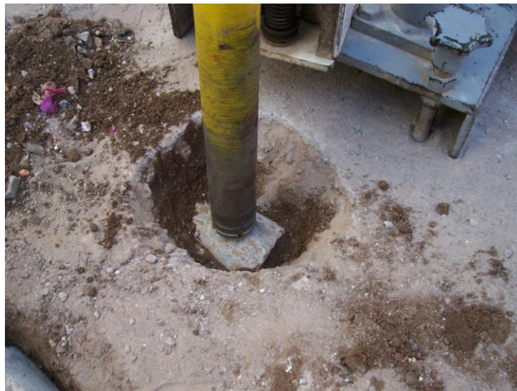
Figura 4.9. Obtención de testigos en cilindros de mortero, Utilizando una brocadora de manera manual.
