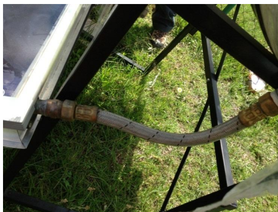
Figura 34. Mangueras flexibles uniendo placa colectora con termotanque
