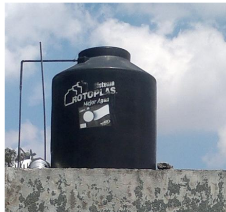
Figura 39. Tanque o contenedor externo al sistema fototérmico
