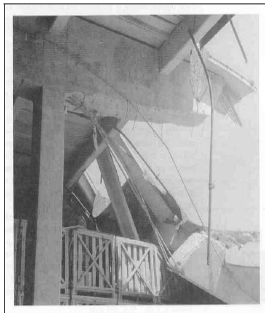
Figura 1. Falla por adherencia en las conexiones viga-columna debido al deslizamiento de las varillas ancladas o falla de cortante
