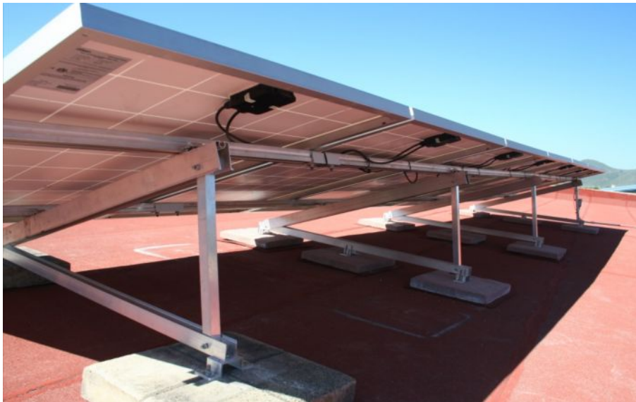
Fig. 2.9.- Estructura de aluminio y rieles para sujeción de los paneles solares.
