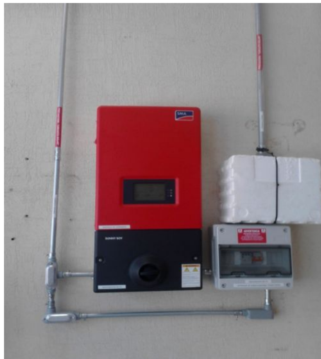
Fig. 2.12.- Instalación del Inversor en el interior del edificio de usos múltiples o Biblioteca.
