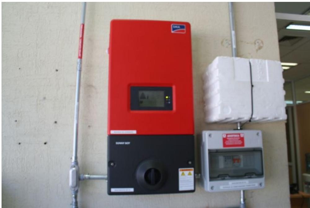
Fotografía del inversor y protección del sistema conectado a la red montado en la entrada de Biblioteca de la UTZMG.
