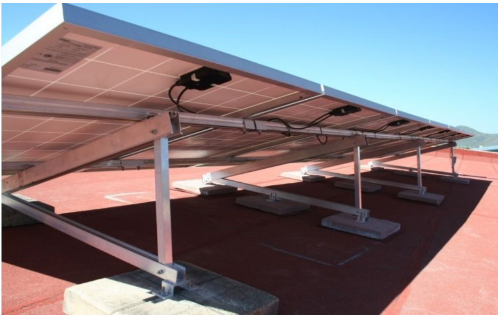
Fotografía del montaje necesario utilizado en los paneles fotovoltaicos de la UTZMG.
