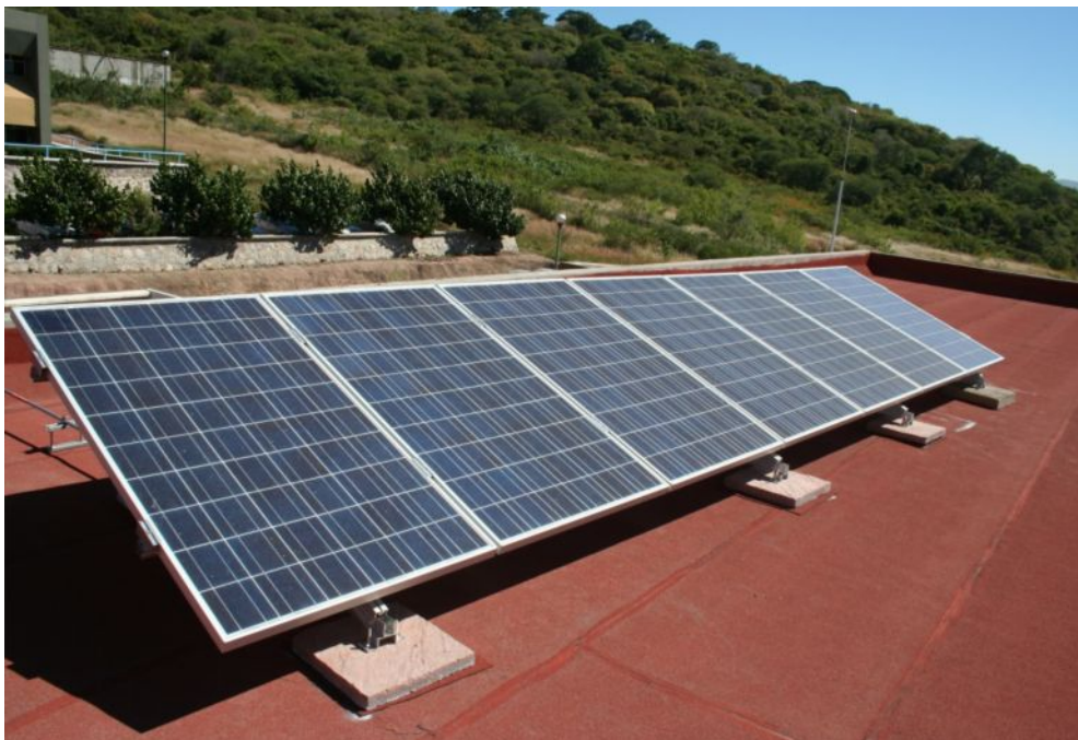
Fotografía de los paneles policristalinos montados en la azotea de la Biblioteca de la UTZMG.
