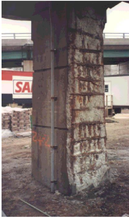
Figura 4. Estructura de concreto reforzado, con problemas de corrosión.
