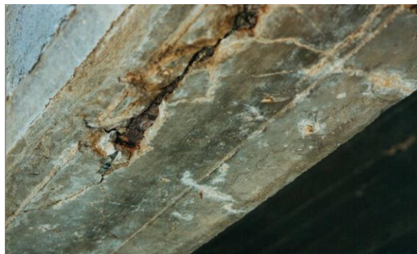
Figura 1. Corrosión del acero de refuerzo®
