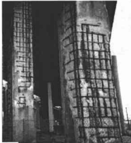
Figura 1.4. Desprendimientos de secciones de concreto debido a la corrosión.
