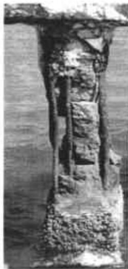
Figura 3. Pilar de un muelle con desprendimiento de concreto por corrosión del refuerzo.
