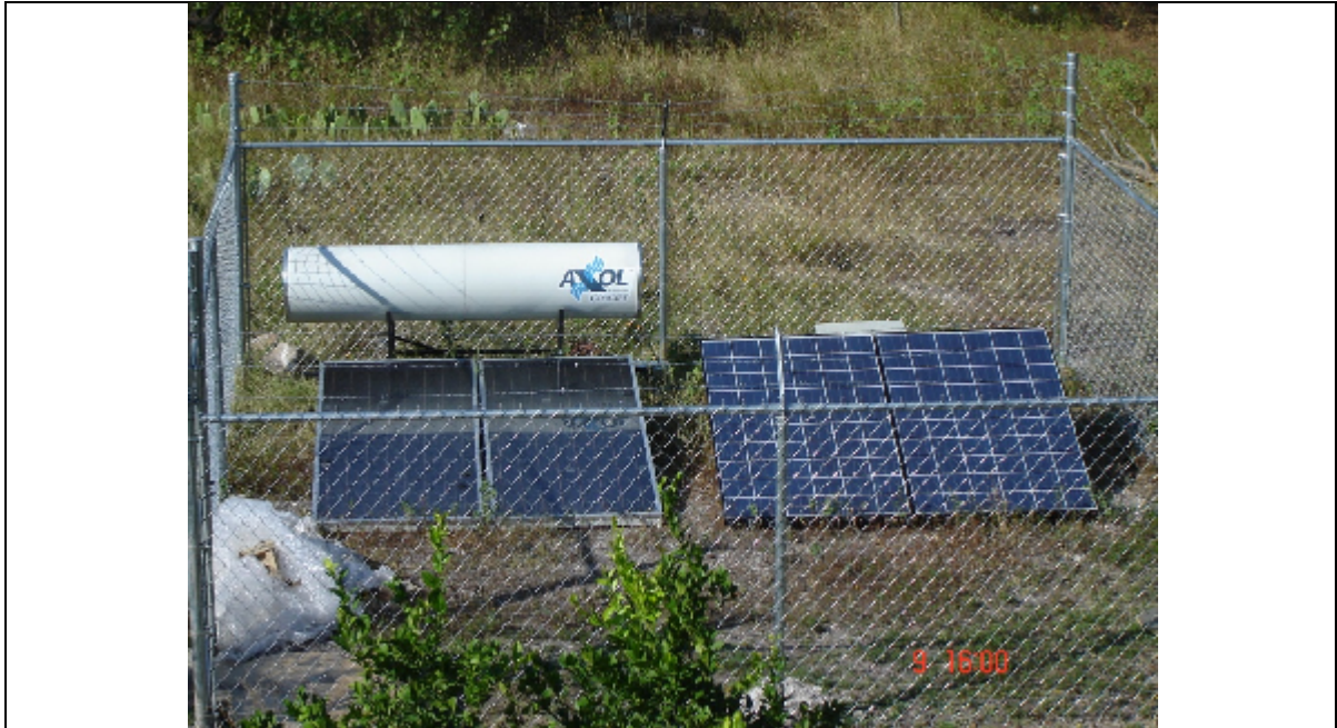
Figura 5.1.4 Colector solar para energía térmica, a la izquierda y panel fotovoltaico para generación de electricidad, a la derecha.
