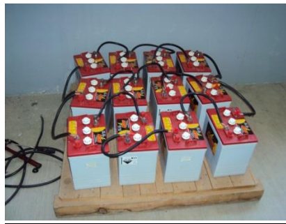
Figura 13. Arreglo de baterías en paralelo
