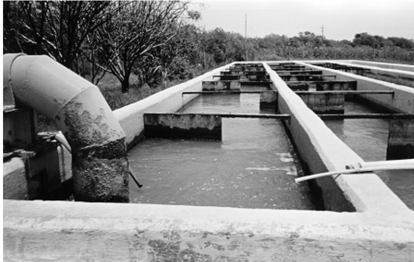
Figura I.2. Ejemplo de unidad de tratamiento con mamparas dañadas ó modificadas.
