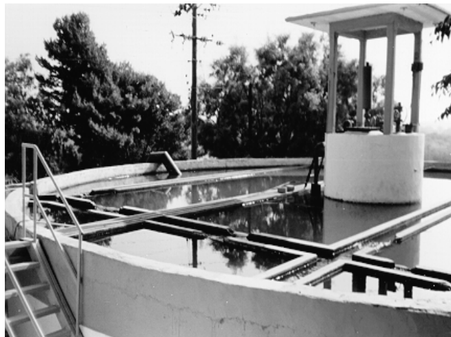
Figura I.1. Las canaletas de recolección del agua clarificada de esta unidad fueron rotas, para “agilizar” el proceso
