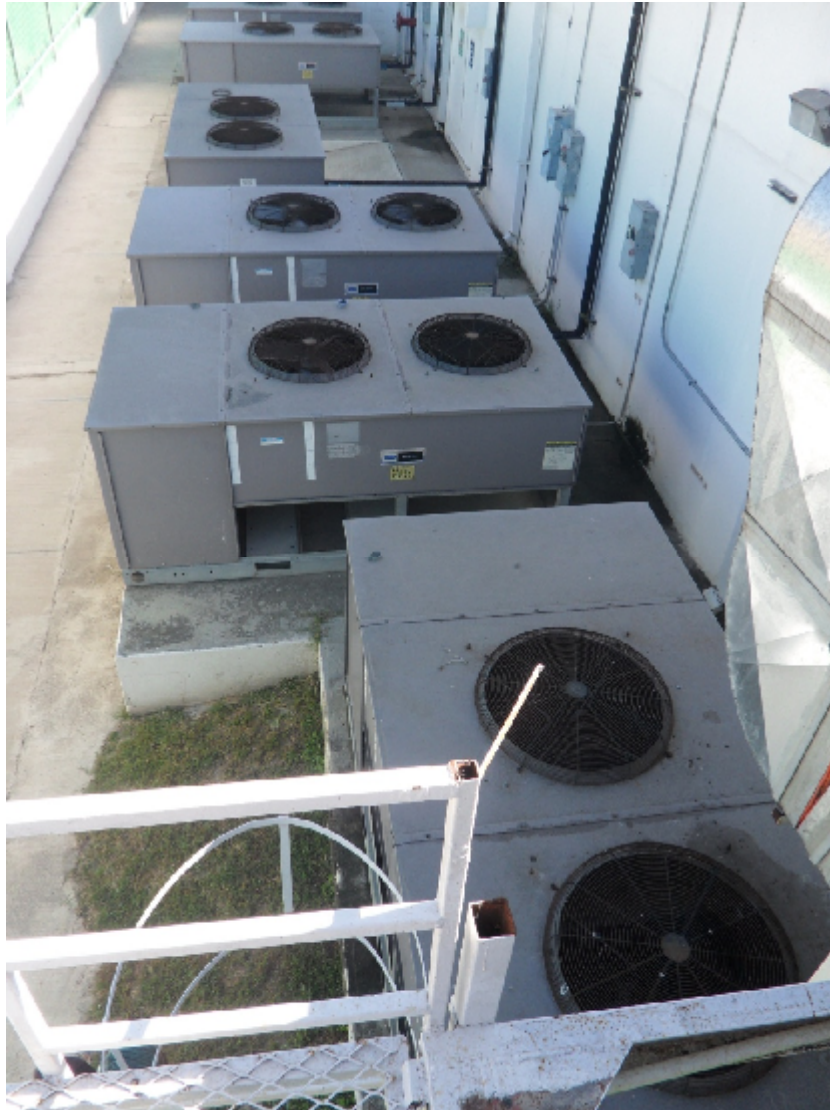
Imagen 37. Equipos de Aire Acondicionado.
