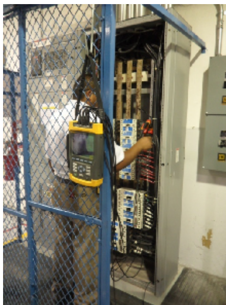
Imágen 4. Medición en tablero de distribución A.
