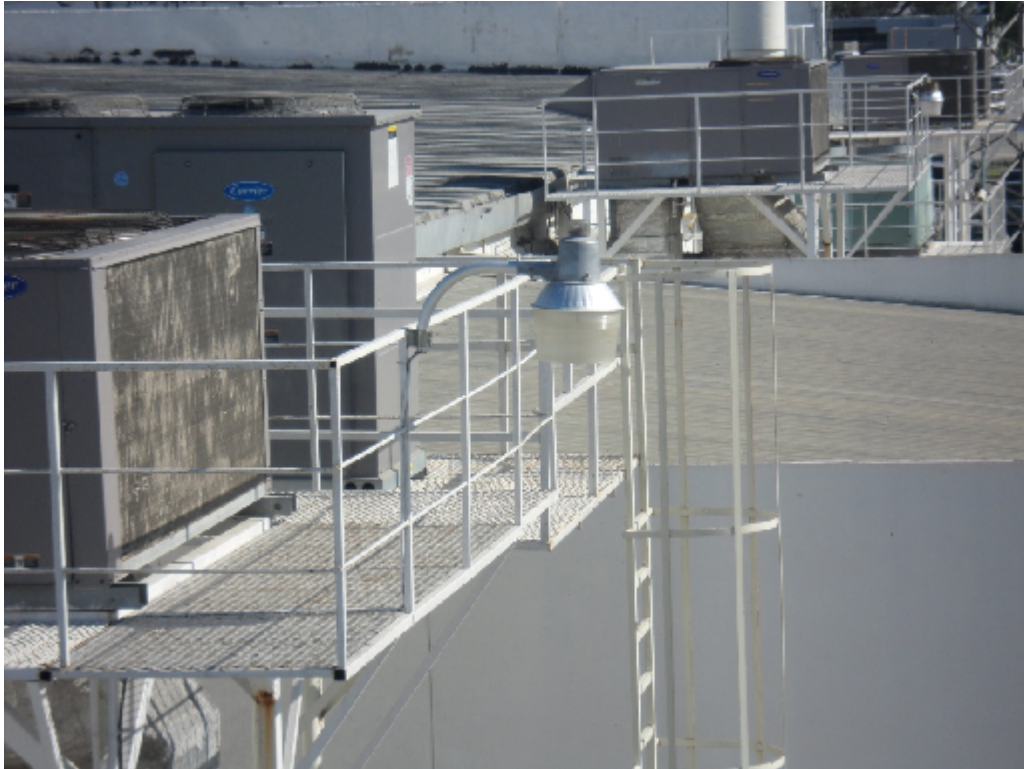
Imagen 38. Equipos de Aire Acondicionado.
