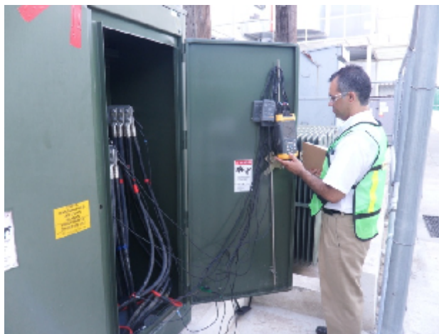
Imágen 3. Medición en Transformador de subestación 1.
