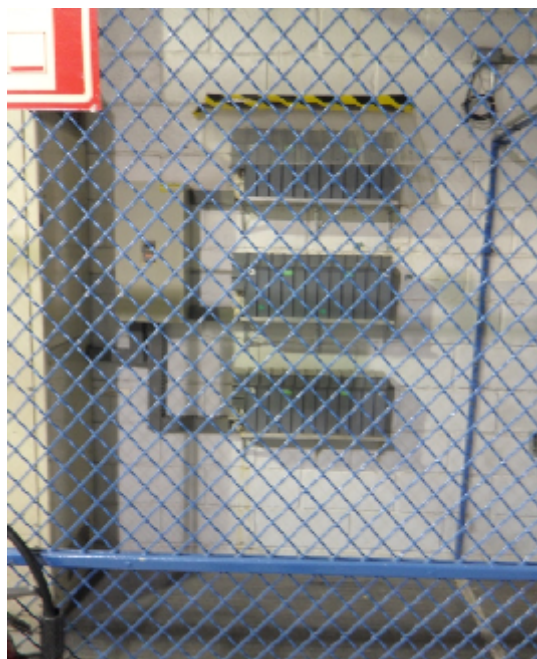
Imagen 48. Bancos de capacitores de subestación 1.
