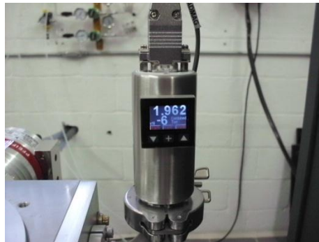
Figura 27 Indicador que muestra la presión de la pre-cámara.
