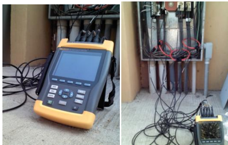
Figura 42 Analizador de redes, Fluke 435A conectado al tablero de aulas ligeras Fuente: Propia
