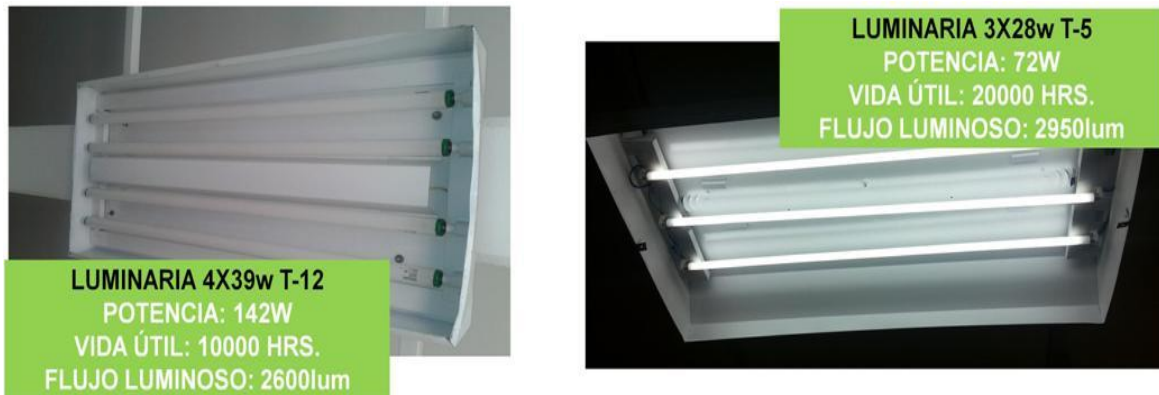
Figura 44. Tipos de luminarias T12 instaladas y T5 por sustituir.
