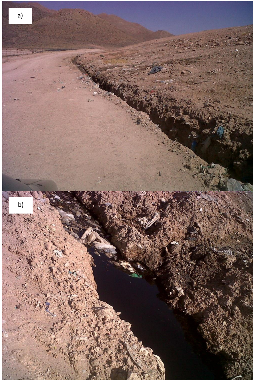
Figura 11. Canal de lixiviados. a) Vista desde el camino para el tránsito de vehículos b) Vista ampliada del canal
